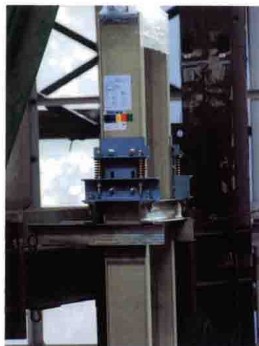
圖 6：匯流排系統各部位構件照片
