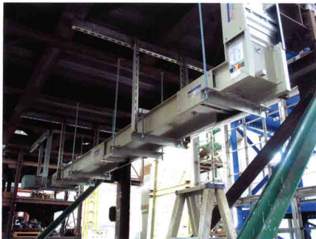
圖 4：匯流排系統各部位構件照片
