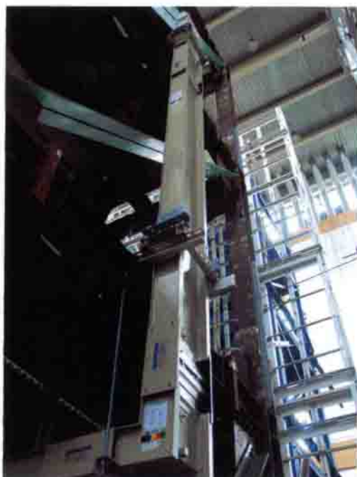
圖 5：匯流排系統各部位構件照片
